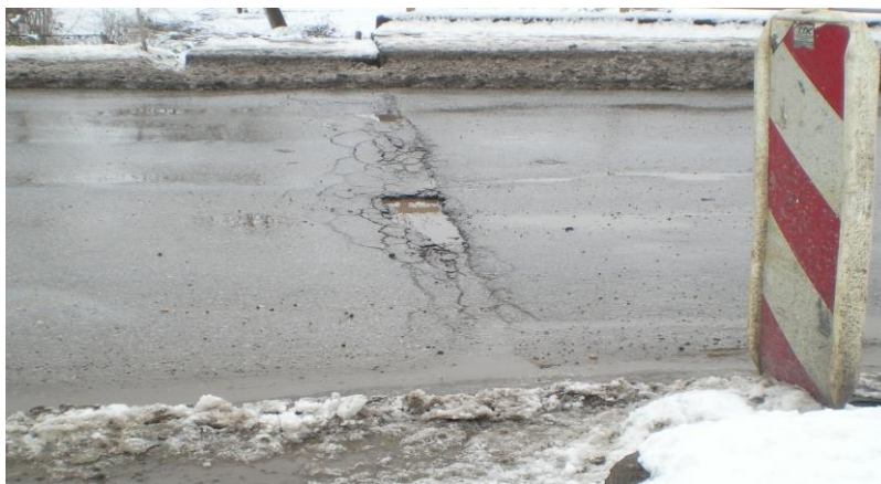
Слика 36. Пример оштећења на деоници
