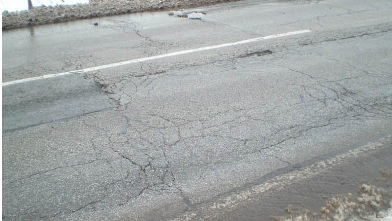
Слика 35. Пример оштећења на деоници
