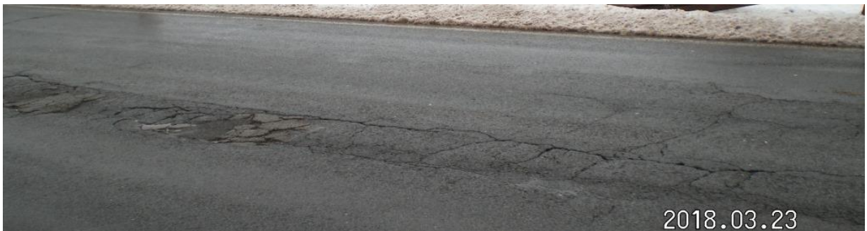
Слика 37. Пример оштећења на деоници
