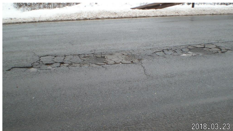
Слика 34. Пример оштећења на деоници
