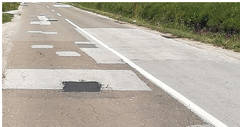
Слика 15. Оштећења на путу
