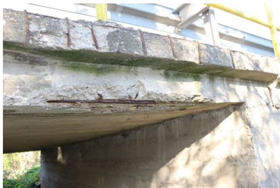
Слика 2-40 km 31+337 отпао заштитни слој малтера
