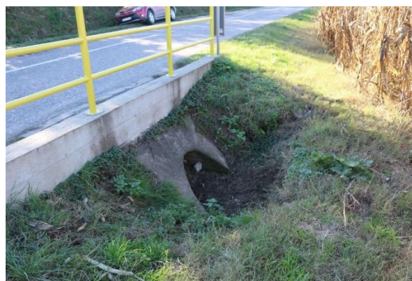
Слика 2-43 km ~30+650 непостојање јарка онемогућава правилно функционисање пропуста
