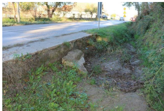
Слика 2-41 km 33+354 пропуст запуњен материјалом поломљена глава пропуста
