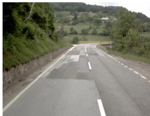
Слика 22. Оштећење коловоза
