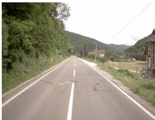
Слика 21. Оштећење коловоза
