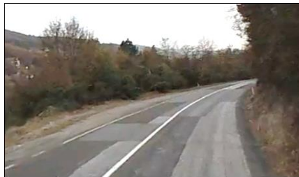
Слика 40: Оштећења коловоза
