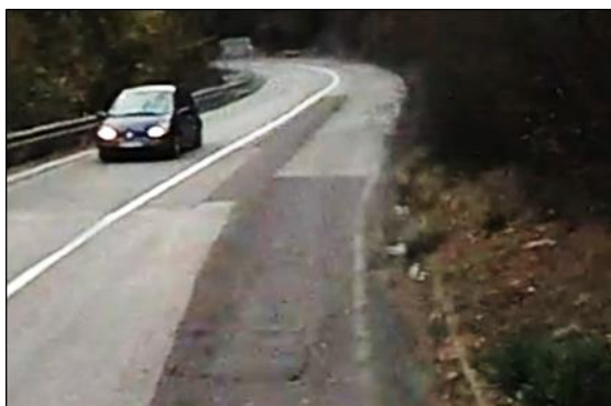
Слика 41: Оштећења коловоза
