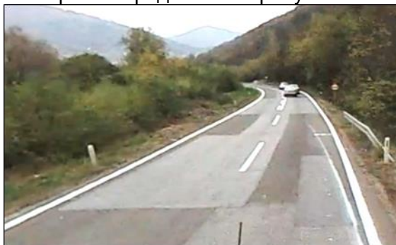
Слика 39: Оштећења коловоза
