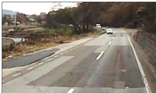
Слика 42: Оштећења коловоза
